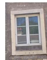
PVC Battée trop épaisse
